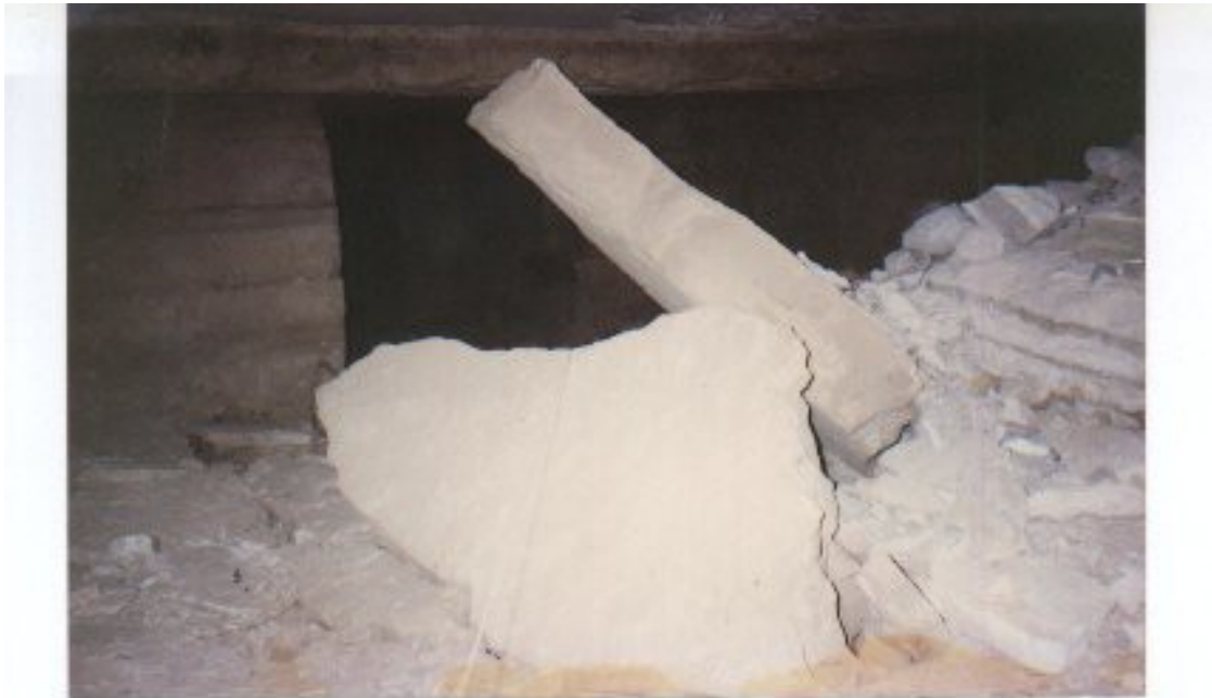
Des plaques se détachent parfois du plafond. Gare là-dessous !!
