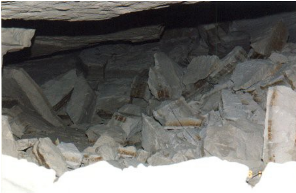
Des plaques tombées du plafond jonchent le sol
